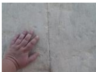
Стыки между плитами поражают и сейчас
